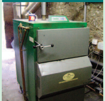
Vigas log boiler
